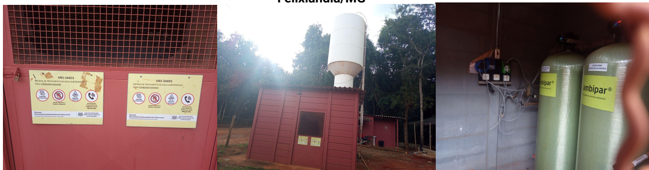
Figuras 13, 14 e 15: Sistemas de Filtragem US1 -141C1 e US1 -141D1 - Comunidade Barra do Paraopeba, Felixlândia/MG
