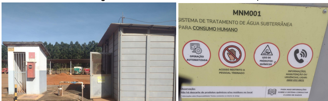
Figuras 26 e 27: Sistema de Filtragem MNM 001 - Comunidade Frei Orlando, Morada Nova de Minas/MG
