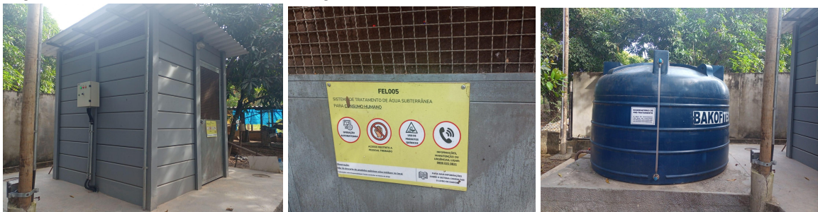
Figuras 05, 06 e 07: Sistema de Filtragem FEL005 - Comunidade Ribeiro Manso - Felixlândia/MG
