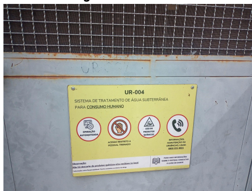
Figuras 18 e 19 : Sistema de Filtragem UR-004 - Comunidade La Poveda, Felixlândia/MG
