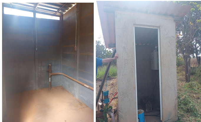
Figuras 08 e 09: Sistema de Filtragem desativado - Comunidade Quintas da Boa Vista, Felixlândia/MG
