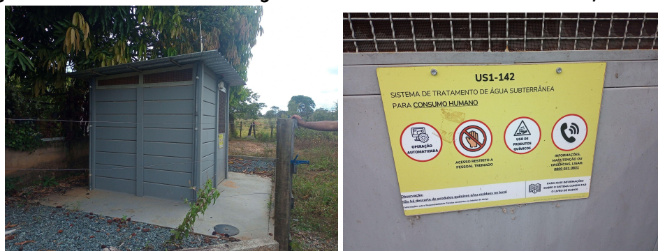
Figuras 16 e 17: Sistema de Filtragem US1-142 - Comunidade Praia Nova, Felixlândia/MG
