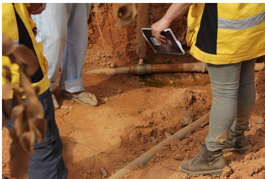
Figura 4: Junção das tubulações provenientes dos poços I e II
