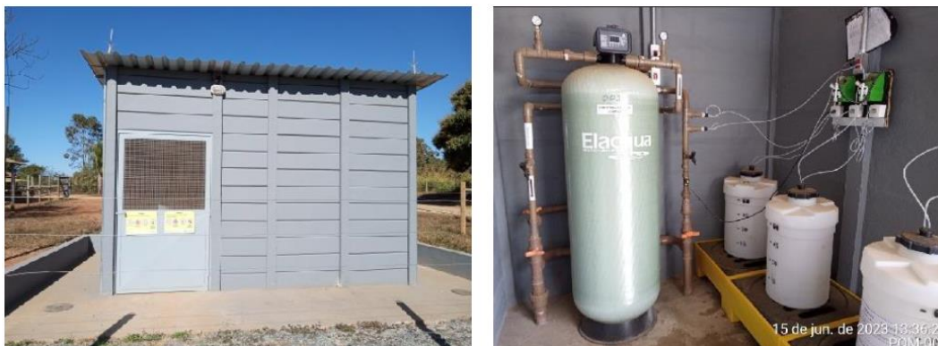
Figura 5 – Abrigo do sistemas de tratamento instalados na Comunidade Fazendinhas Baú
